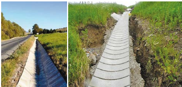
(foto: 79 – 80) Rigoly a prícestné priekopy zbierajú dažďovú vodu a transportujú ju do najbližšieho potoka. Prícestná priekopa na diaľničnom obchvate Popradu spôsobila lokálnu záplavu v obci Jánovce pri Poprade a tiež škody na diaľničnom zvršku.
