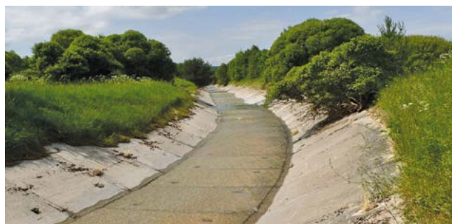
(foto: 77) Betónom vydláždené koryto nad obcou Ľubica prispelo k povodňovým škodám v Ľubici a Kežmarku a k vysušovaniu územia
