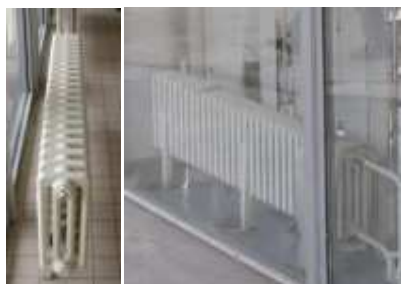
Obr. 5 Vykurovacie teleso v priestoroch objektu
