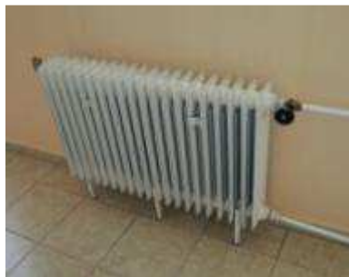
Obr. 6 Vykurovacie teleso v priestoroch objektu
